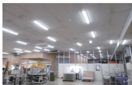
印刷工場検査エリア付近のLED照明
